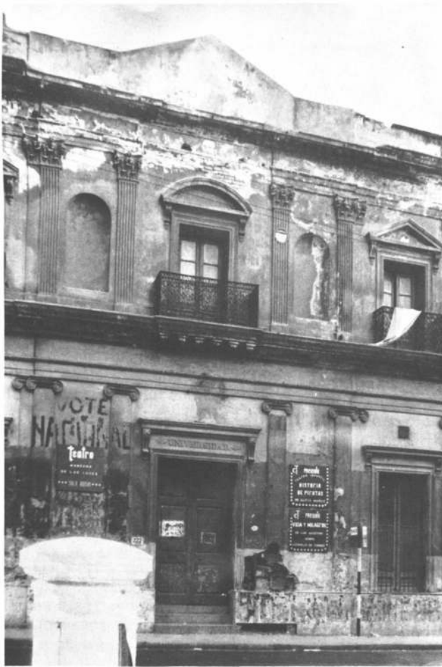
Entrada principal de lo que fuera la Universidad de Buenos Aires antes de la restauración
