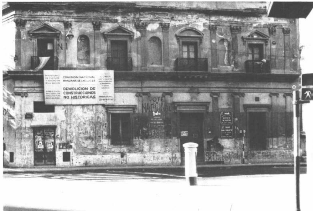
Estado que presentaba la fachada de la calle Perú antes de que se comenzara con los trabajos de restauración.
