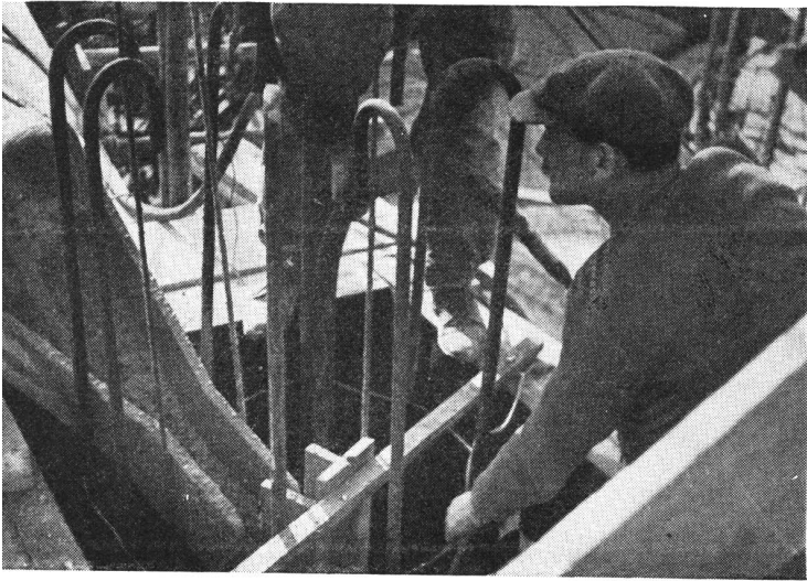
Un aspecto del colado del hormigón ayudado por el uso de dos vibradores, uno interno y otro externo al encofrado.
