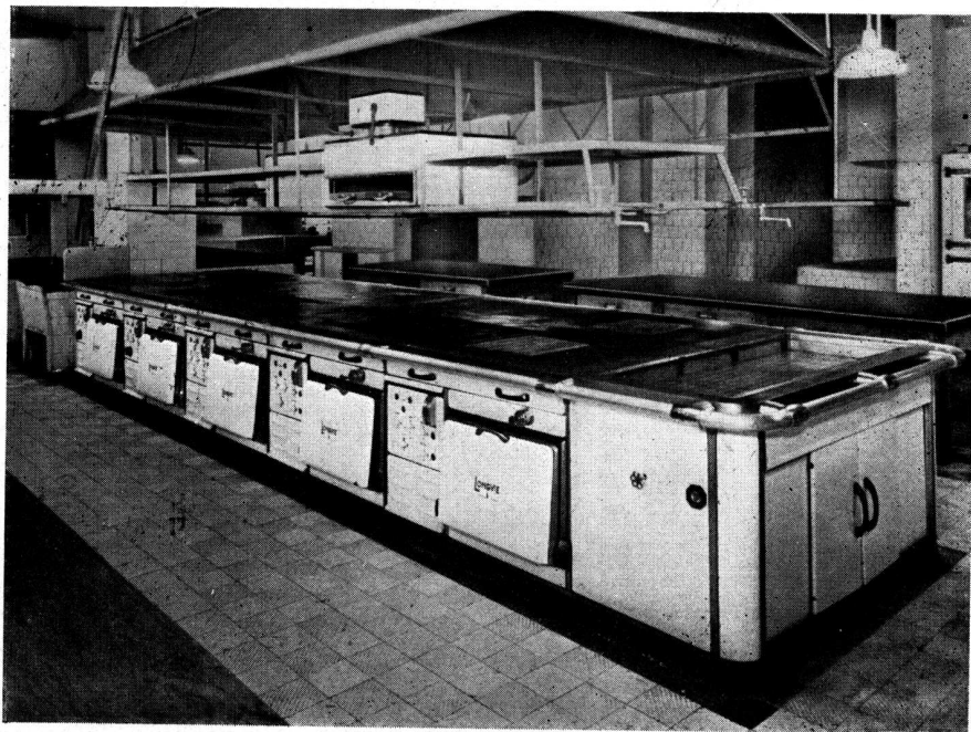
Fig. 4—COCINA ELECTRICA CENTRAL DE 163 kW DE POTENCIA
