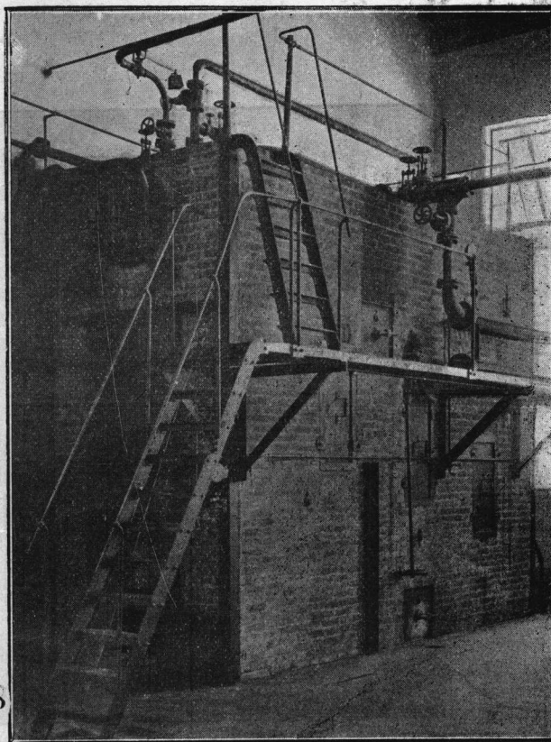
DEPARTAMENTO DE CALDERAS
