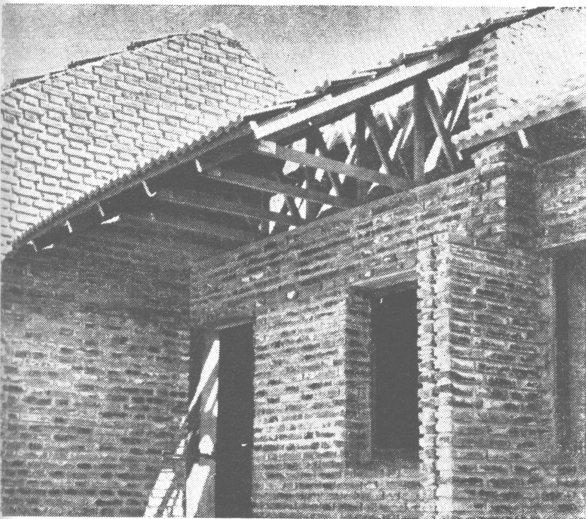
La cubierta de tejas se apoya en los muros exteriores de las viviendas. Los tabiques interiores no reciben carga del techo.
