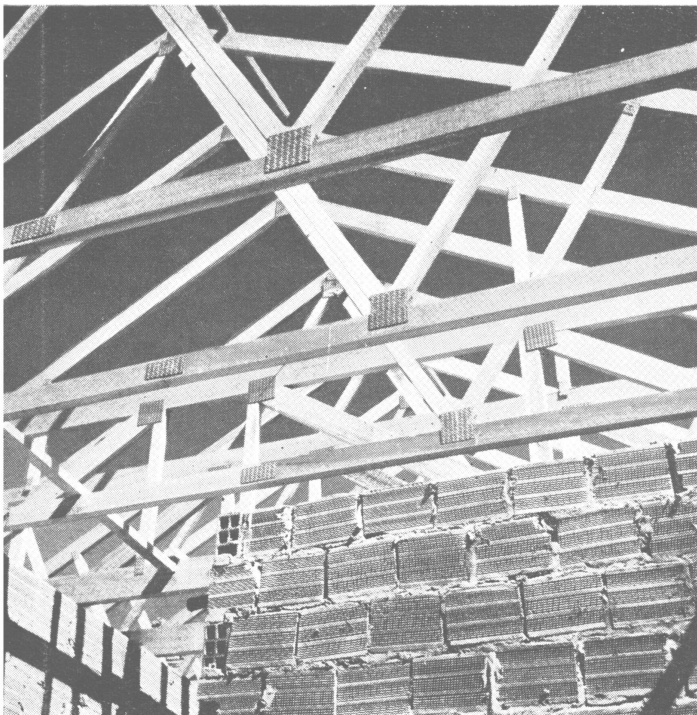
La pendiente de 30° en los tejados permitió eliminar el entablado y los fieltros asfálticos, brindando una buena cámara aisladora.
