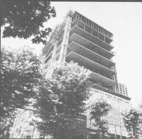
EDIFICIO TORRE (28 pisos). Virrey Loreto 1726. Empresa Constructora: G. ALFONSO FERRARIS S R L Rio Bamba 469 - p. 9
