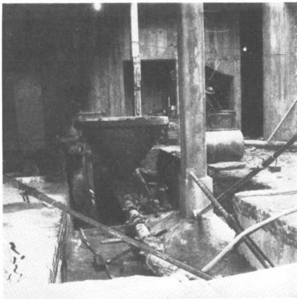
Mezcladora de dosificación mecánica y bomba inyectora que, por tuberías telescópicas, enviaba mezcla a cualquier lugar de la obra.
