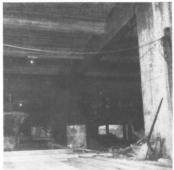
El subsuelo se hizo con sistema tradicional: bases de un volumen de hormigón armado, vigas principales y secundarias y una losa.
