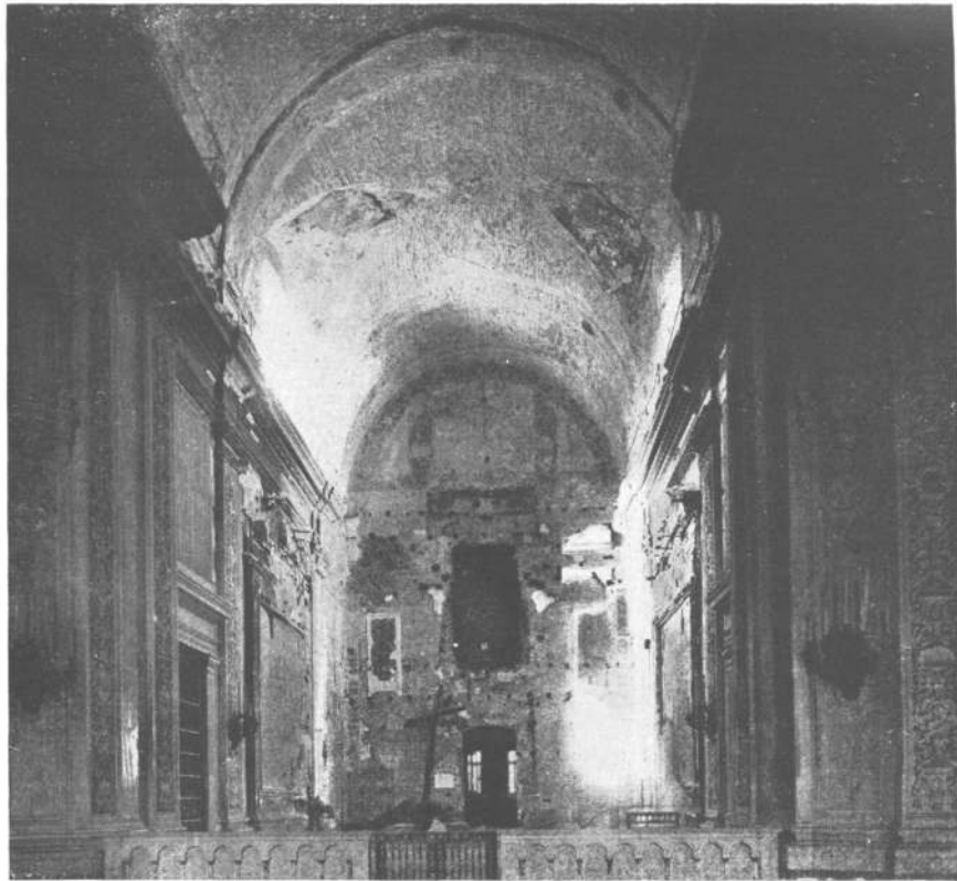
Vista tomada poco después de la destrucción. La caída del altar dejó a la vista una moldura original; compárese la con las realizadas en 1944. Se advierten también restos de los mosaicos venecianos que recargaban la bóveda, aditamentos marmóreos y rosetones.
