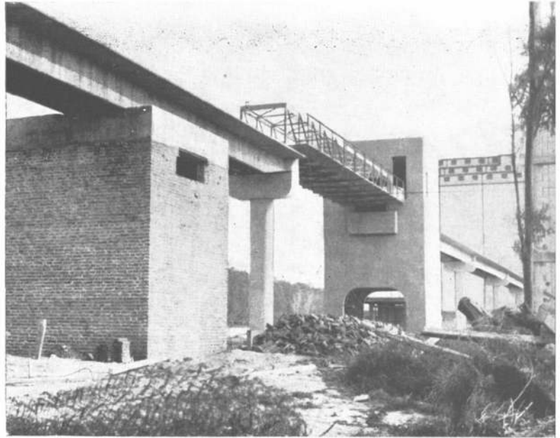
Fotos: (arriba) Cabina de Maniobras y Medición y Torre 2; (abajo) vista de la Torre A y Manipuleo.
