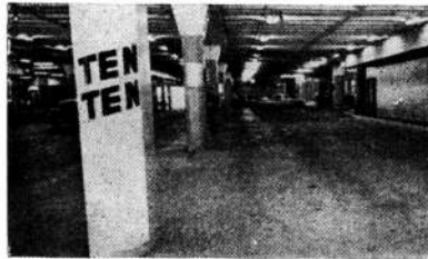
12.— El piso de este garaje, de neopreno y hypalon, constituye una superficie elástica, resistente y sin juntas.
