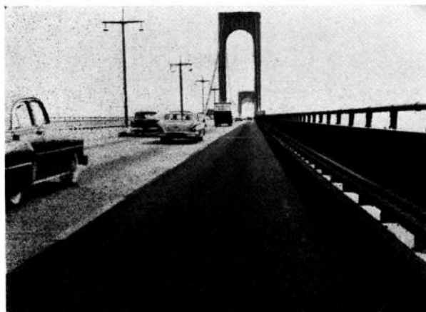
7. — El tramo oscuro de la derecha, a base de resinas epoxi, en este puente colgante de Nueva York, soportó sin degradación el tránsito de más de 5 millones de vehículos en el período de seis meses.
