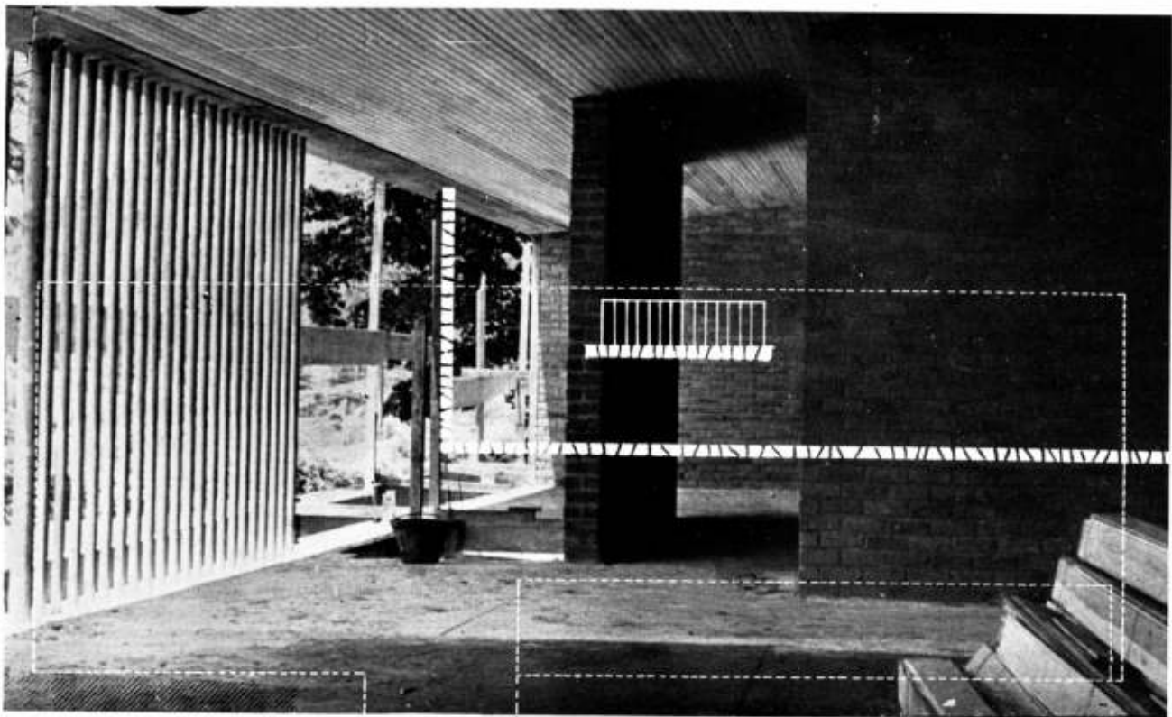
Interior de la sala de estar, en construcción. Sobreimpresa, la planta inferior con la entrada.
