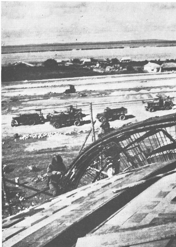
La necesidad de ejecutar la obra en un tiempo menor de 6 meses obligó a organizar el trabajo nocturno. Se aprovechó la ventaja estructural que ofrece soldar los hierros de los refuerzos.
