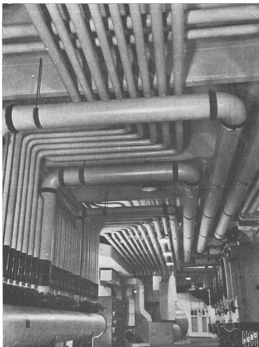
Vista parcial de la sala de calderas con distribución de cañerías.
