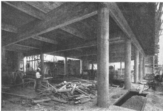
Un detalle de la estructura de hormigón del edificio construido con "INCOR" cuyos moldes, en algunas partes de la obra, fueron retirados a las pocas horas, con el consiguiente ahorro de gastos en los encofrados.
