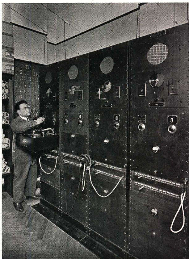
Equipo instalado en el City Hotel, Buenos Aires
