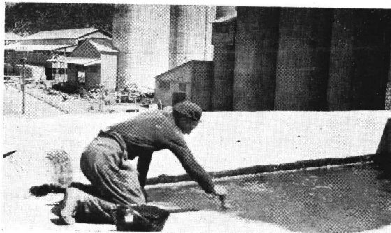
Silos de la fábrica cemento Minetti en Dumesnil Cubiertos con "DURSIT" - Empresa Constructora "GEOPÉ"
