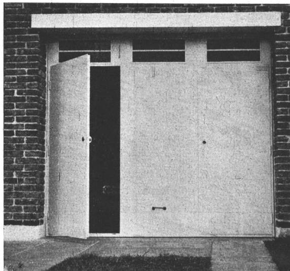
Puerta de garage instalada en una villa construida en San Isidro (Arq. Carlos Vilar) Mide 2,40 x 2,20 y es de acero. Lleva en su parte superior vidrios Georgian y a un costado puertas de servicio de 0,70 x 1,75 de alto
