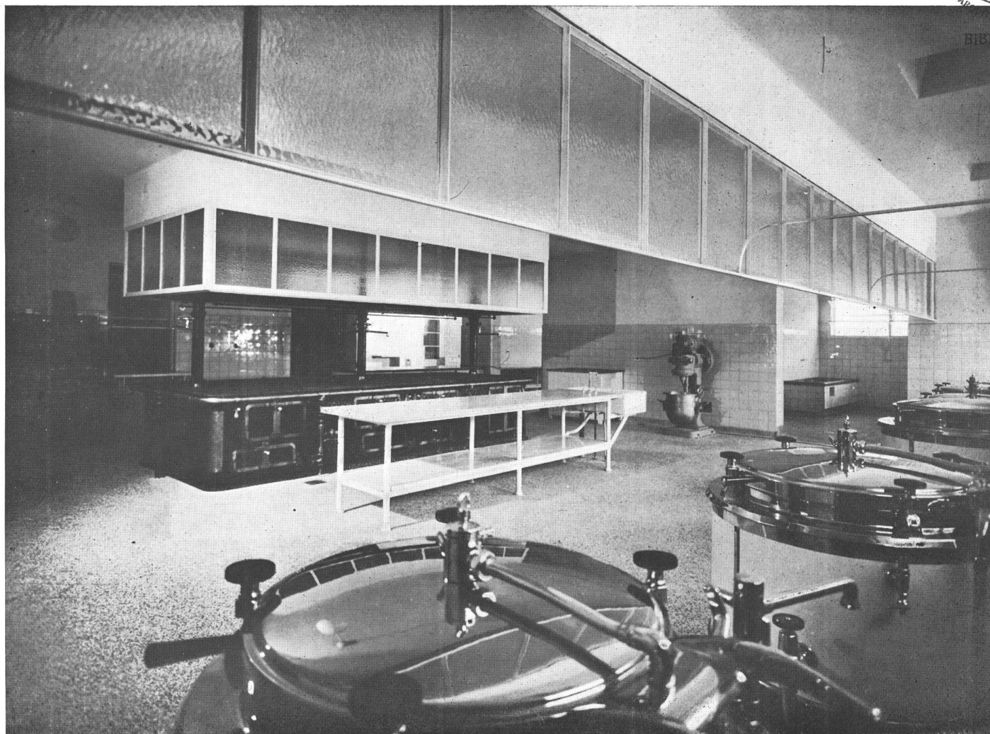
HOSPITAL MILITAR CENTRAL. Cocina central a fuel oil, ollas a vapor. Al fondo se puede ver una de las máquinas batidoras universal, eléctrica. Las campanas de aspiración llevan mamparas de vidrio catedral. Pisos de zócalos graníticos reconstituídos; revestimientos de azulejos. Mesa de caño de hierro pintado y planos de mármol blanco
