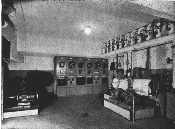
Fig. 14 - Tablero de Hidro-elevadores
