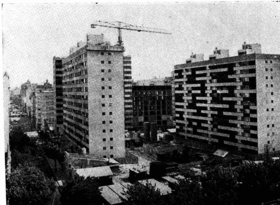
El conjunto realizado por Pueyrredón Construcciones en el estado en que se encontraba en febrero.
