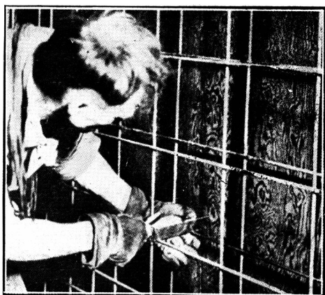
Chapas de madera y separadores metálicos para las formas de los tabiques de hormigón.
