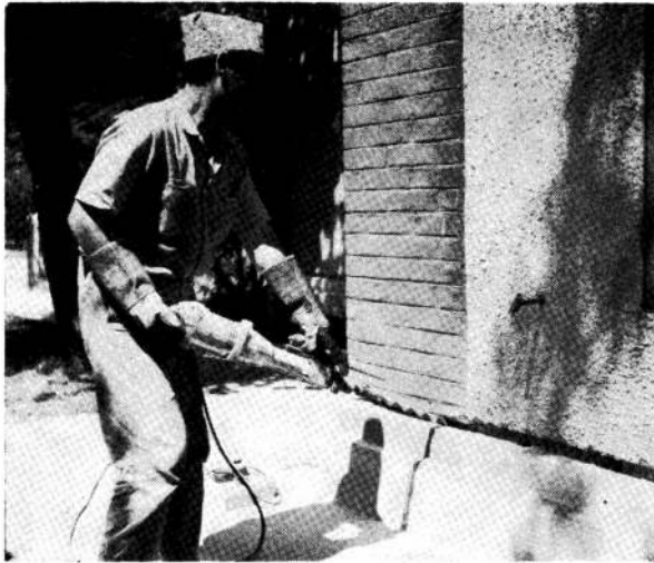
Ya terminada la canaleta se realizan los agujeros para colocar los electrodos. Se utiliza martillo eléctrico rotativo Kango 750 "X".
