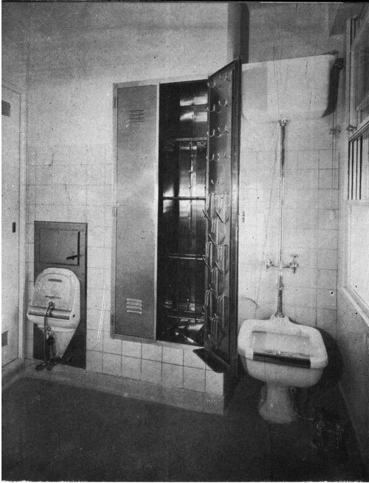
PISOS DE ENFERMOS — LAVACHATAS ESTERILIZADOR
