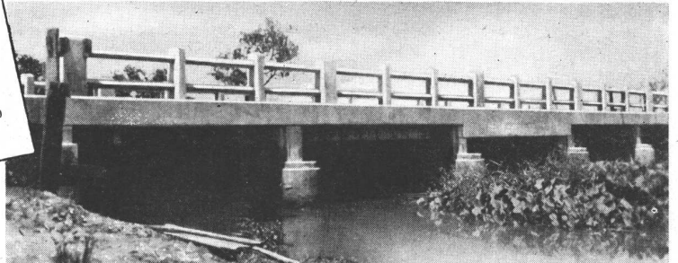
Puente de hormigón de cinco tramos construido íntegramente con 'INCOR', próximo a la localidad de Ypacarai (E. 5) en el camino de Asunción a Villarrica - Paraguay
